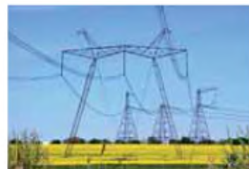
Рис. 33. Провисання проводів ліній електропередач
